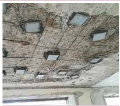
havarijní stav stropu v hale Vincentka
